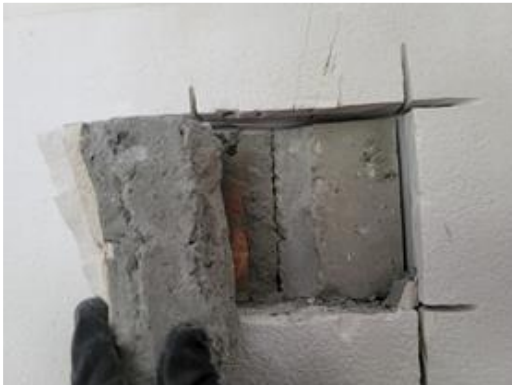
Imagen 52. Sobreespesor de pañete.
