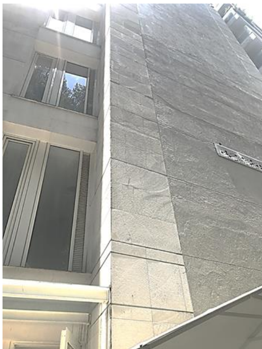
Imagen 41. Esquina de fachada con fisuras verticales.
