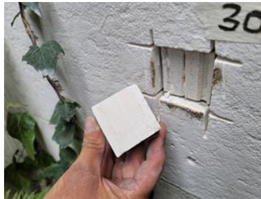
Imagen 57. Baja adherencia entre piedra y material de pega. Proceso de pega mal realizado, no se sentó bien la baldosa, los carriles de la llana están intactos.
