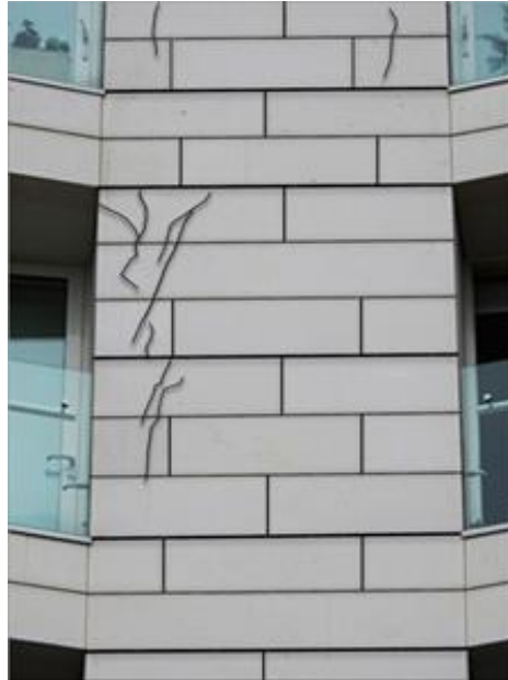
Imagen 44. Detalle de ubicación de las fisuras.
