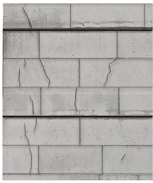
Imagen 34. Detalle de fisuras.
