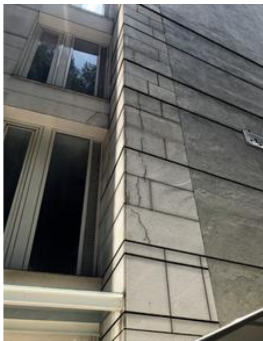
Imagen 42. Detalle de ubicación de la fisura en la esquina.
