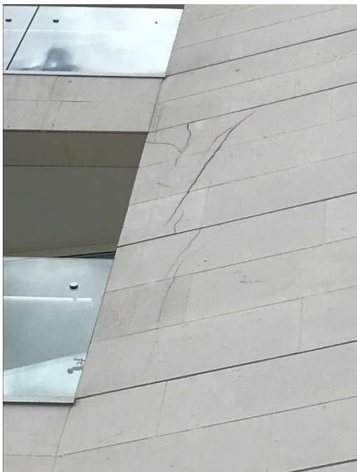
Imagen 22. Grietas y fisuras.
