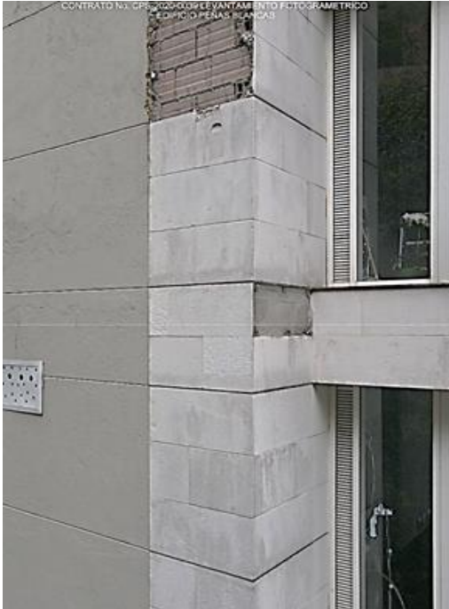
Imagen 39. Esquina de fachada con fisuras verticales.
