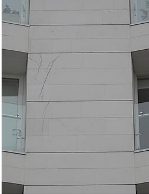
Imagen 43. Fachada frontal fisuras diagonales.
