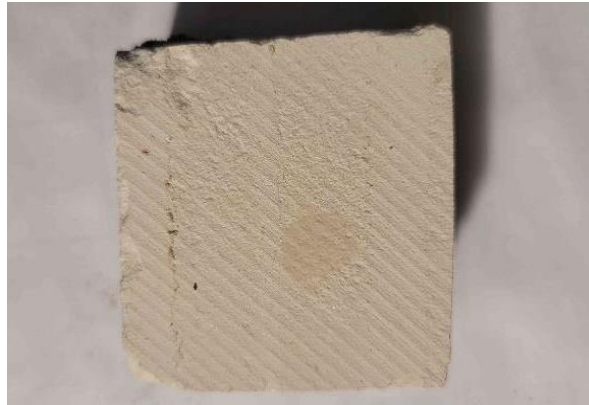
Imagen 78. Completa ausencia de material de pega sobre la pieza, probeta extraída en zona hueca.
