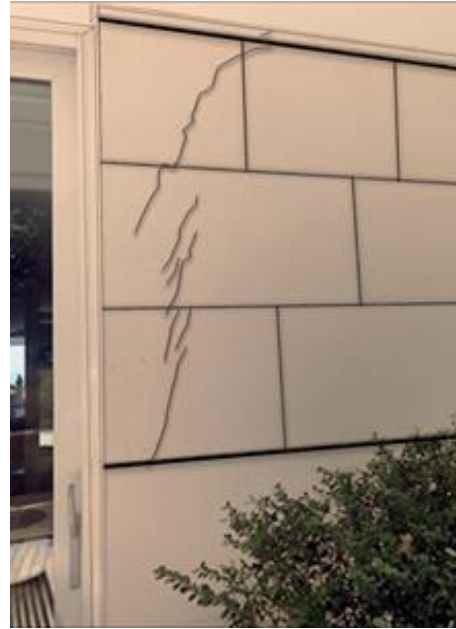
Imagen 46. Fachada frontal - balcón fisuras diagonales. Detalle.
