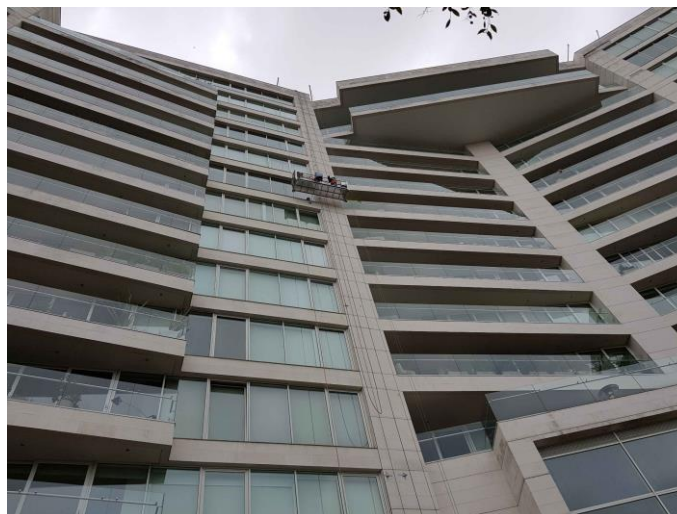
Imagen 1. Vista de la fachada occidental durante las pruebas hechas usando andamio colgante
