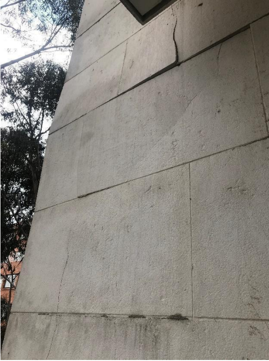
Imagen 18. Abombamiento y fisuración.
