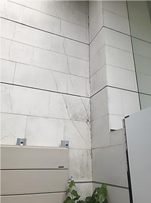
Imagen 47. Fachada norte - fisuras diagonales.
