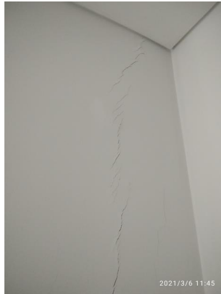
Imagen 28. Vista interior del muro afectado. Apto 506. Muro interno hacia fachada.
