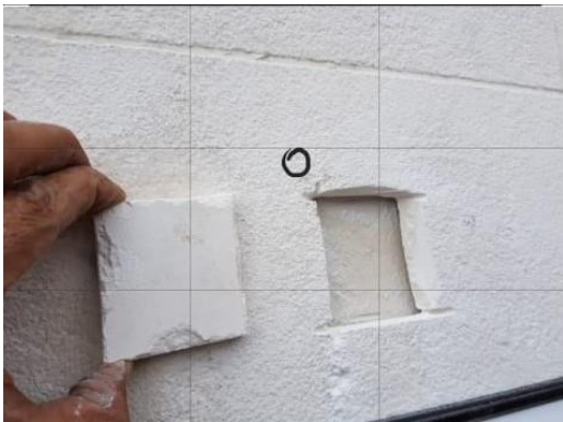
Imagen 56. Baja adherencia entre piedra y material de pega. Se evidencia una separación de la baldosa del material de pega y el espacio hueco entre baldosa y pega.
