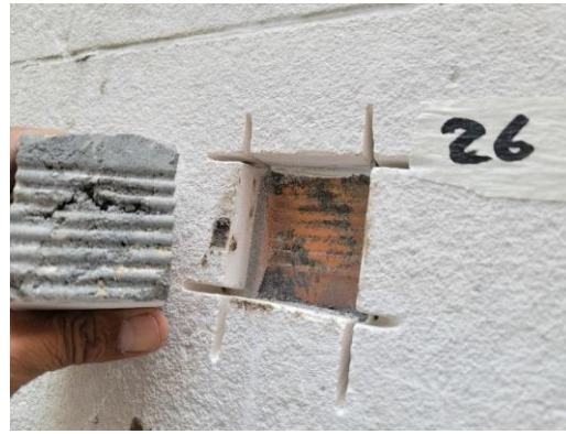
Imagen 51. Baja adherencia entre el pañete y el bloque.
