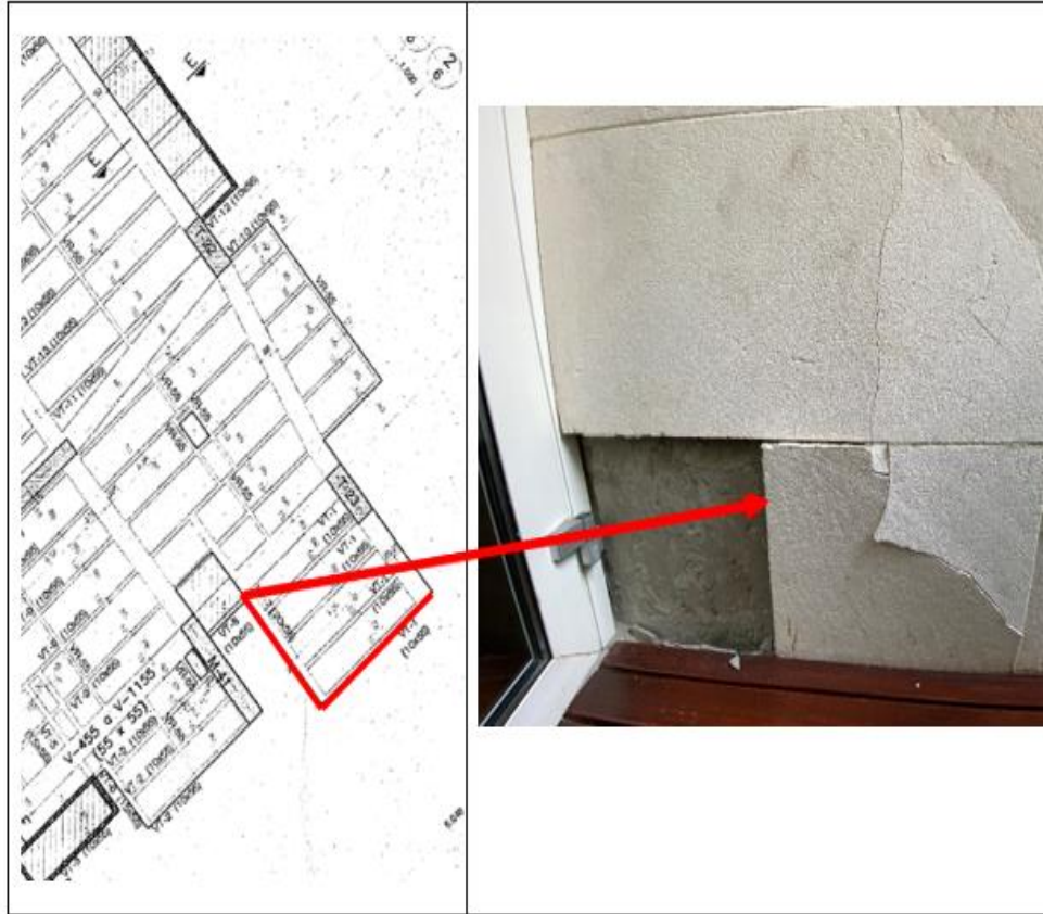
Imagen 6. Afectación Muro no estructural Fachada sur.
