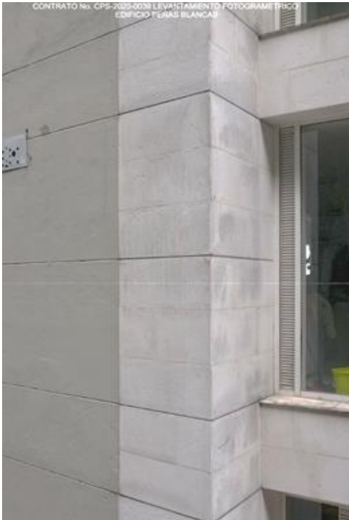
Imagen 35. Esquina de fachada con fisuras verticales.
