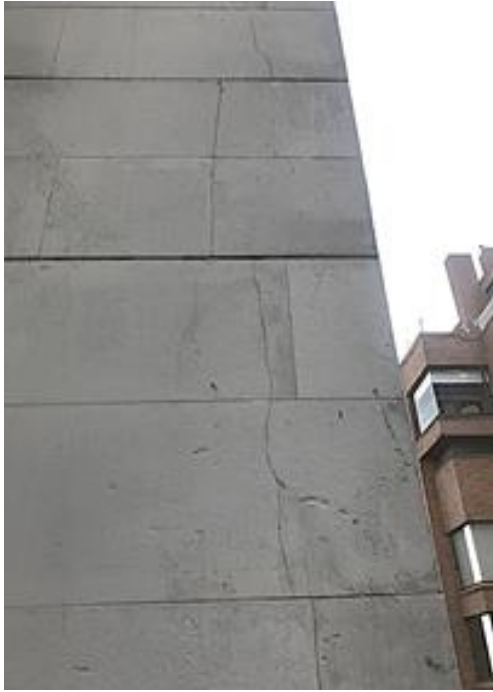
Imagen 37. Esquina de fachada con fisuras verticales.
