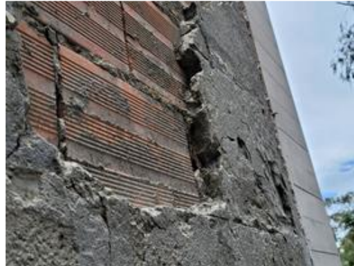
Imagen 53. Sobreespesor de pañete.
