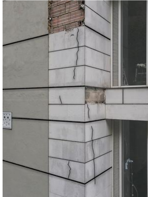
Imagen 40. Detalle de ubicación de la fisura en la esquina.
