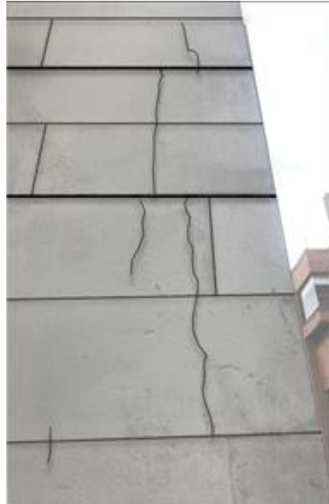
Imagen 38. Detalle de ubicación de la fisura en la esquina.
