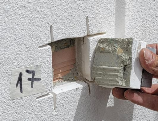
Imagen 50. Baja adherencia entre el pañete y el bloque.
