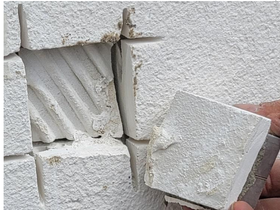
Imagen 55. Baja adherencia entre piedra y material de pega.
