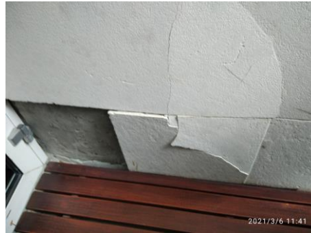
Imagen 29. Deterioro en balcón a nivel de placa de entrepiso
