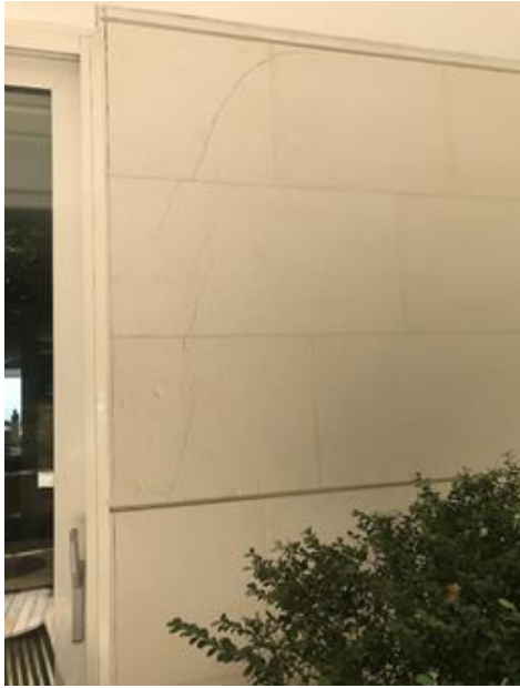
Imagen 45. Fachada frontal - balcón fisuras diagonales.
