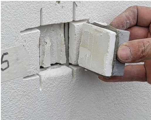
Imagen 54. Baja adherencia entre piedra y material de pega. Se evidencia un vacío existente entre la baldosa y la pega.
