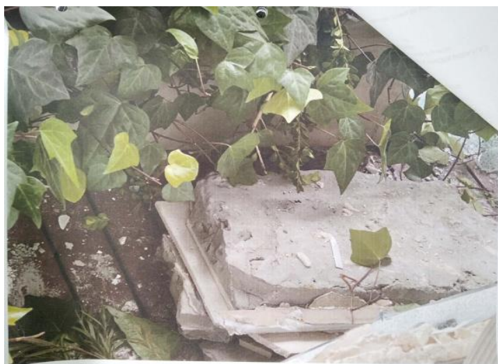
Imagen 3. Desprendimiento de enchape y material de pega.
