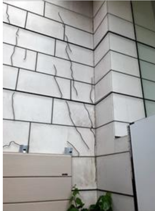
Imagen 48. Fachada norte - fisuras diagonales. Detalle.
