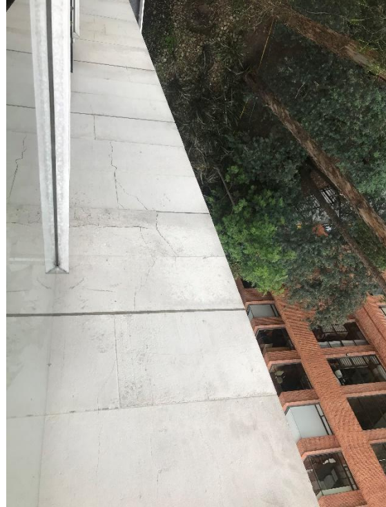
Imagen 19. Abombamiento y fisuración.
