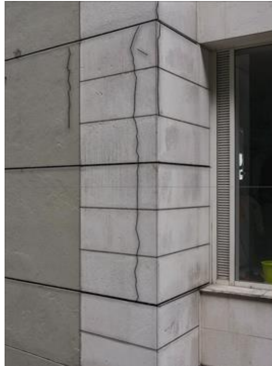
Imagen 36. Detalle de ubicación de la fisura en la esquina.
